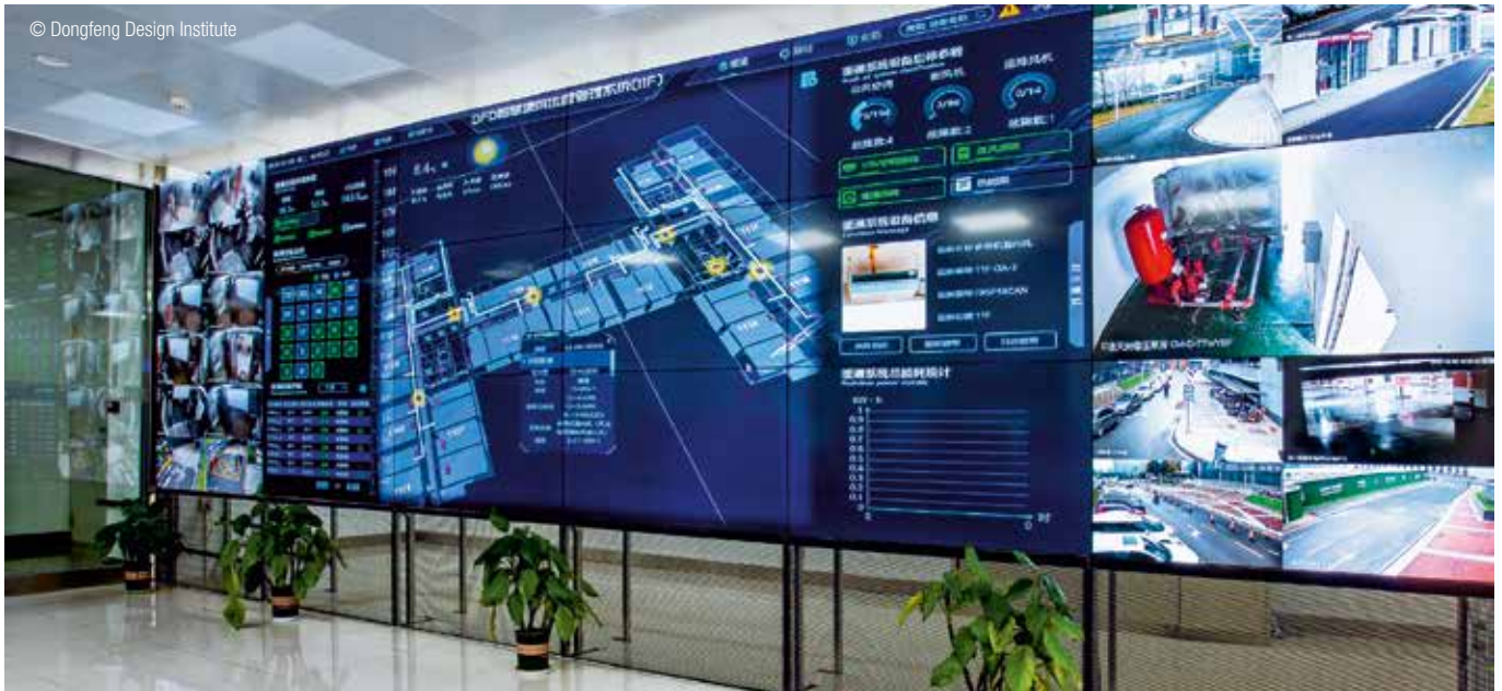
Das Gebäudemanagementsystem umfasst alle relevanten Teilsysteme. The building management system incorporates all relevant sub-systems.
