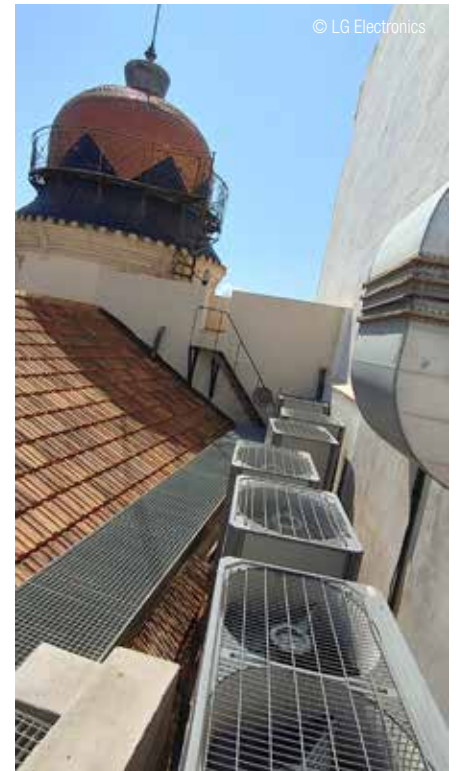
LG Multi V: VRF-Dachinstallation von Außengeräten. LG Multi V: VRF roof installation of outdoor units.
