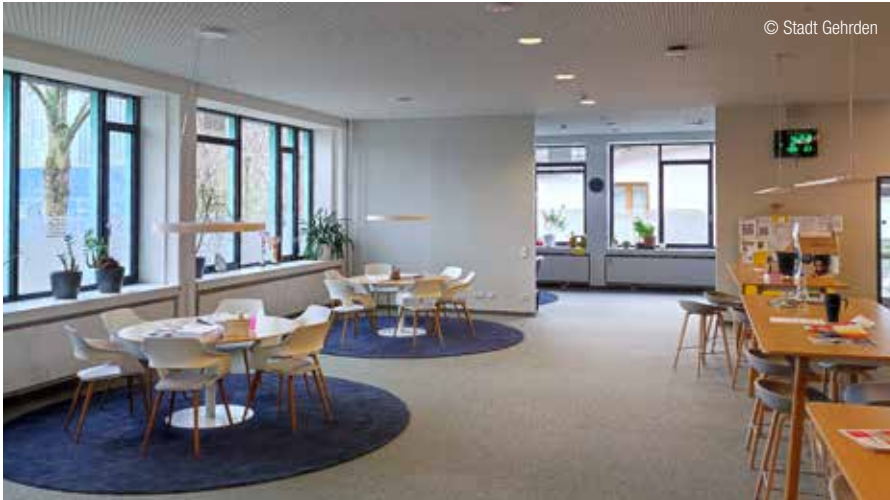
Lehrerzimmer mit O3-Raumautomation zur Präsenzerfassung. Teachers' room with O3 room automation for presence detection.
