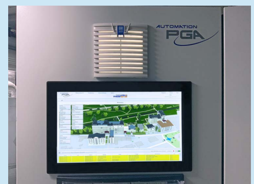
homogenes Gebäudemanagementsystem (BMS), hier unser 21 Zoll Multitouchpanel
