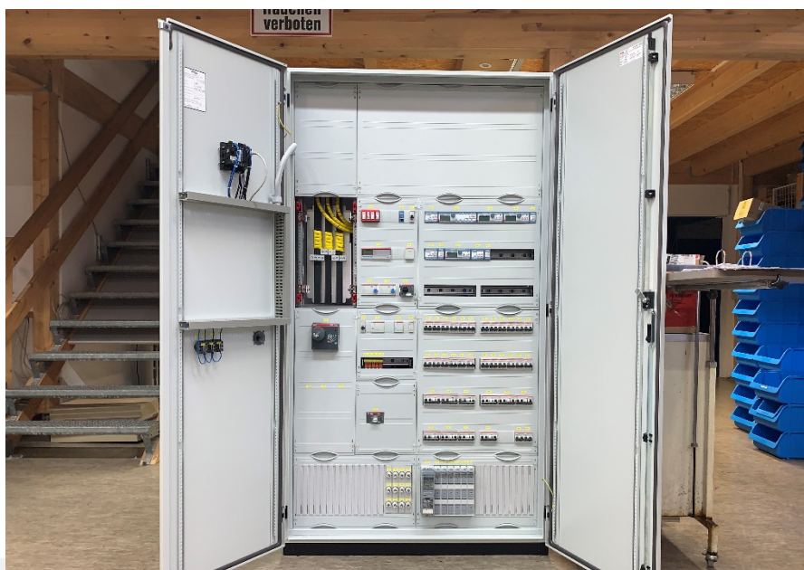
Abbildung 6 UV / AV Schwimmbad Technik
