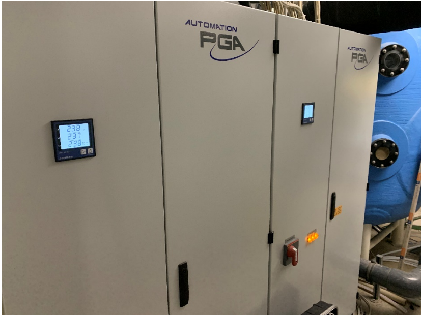
Abbildung 2 Schaltschrank Schwimmbad - Orangerie
