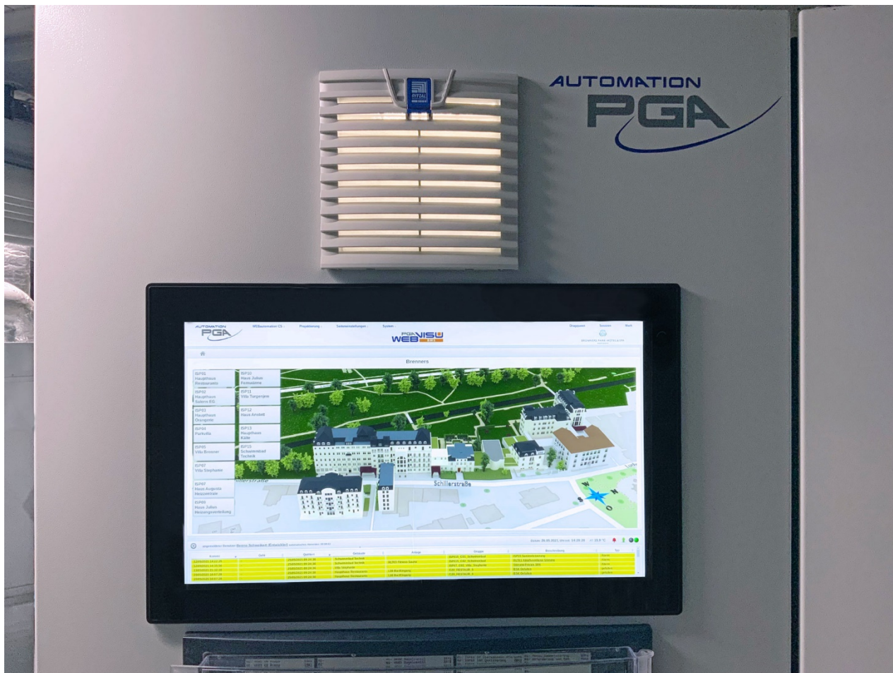
Abbildung 7 Schaltschrank Schwimmbad Baustelle
